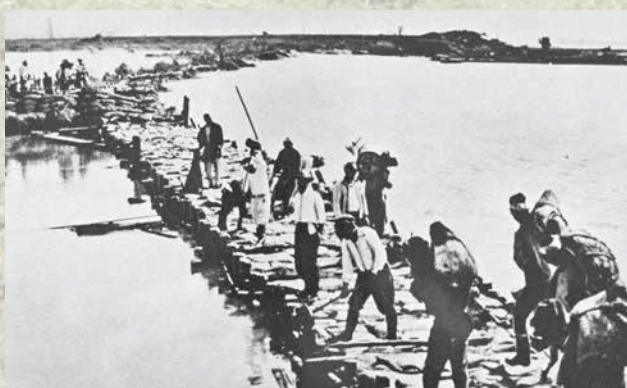
▲土のうでふさがれる宇治川堤防決壊口(昭和28年水害)
