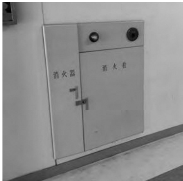
南京錠で施錠されていた消火器具庫(久御山中学校校舎内)
