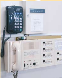
【警察へ直通の警察非常通報装置】
