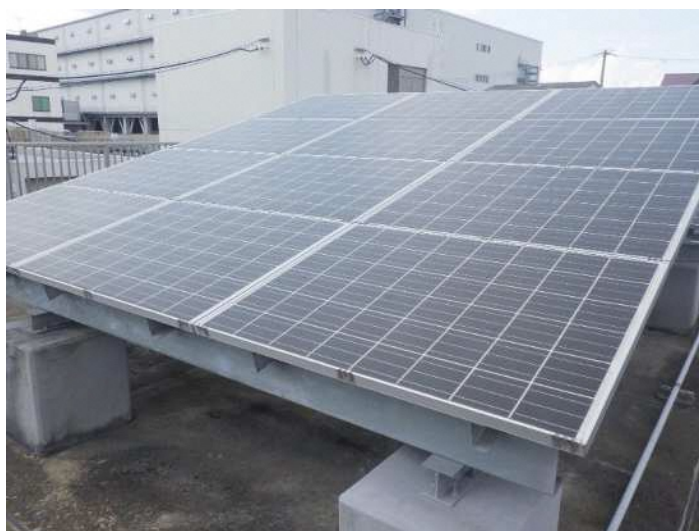
写真 7.1 佐古浄水場の太陽光発電システム
