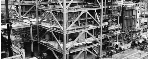
膨大な処理施設が必要となる(直島環境センター・有価金属リサイクル施設)
