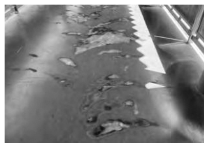
小学校渡り廊下の老朽化の様子
