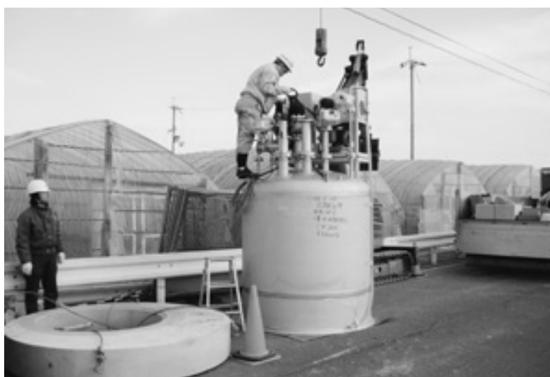
地下に埋設される真空ステーション
